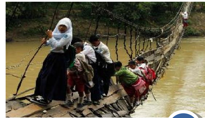
KORUPSI MENGHAMBAT PEMBANGUNAN
